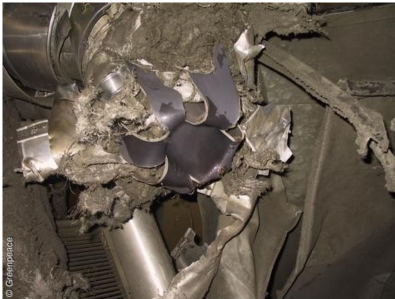
Rohr am Reaktordruckbehälter nach Wasserstoffexplosion
