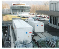
Die Anlage umfasst (von links im Uhrzeigersinn) den Batteriespeicher, den Konverter, einen Zwischentransformator und die Niederspannungsverteilung.
